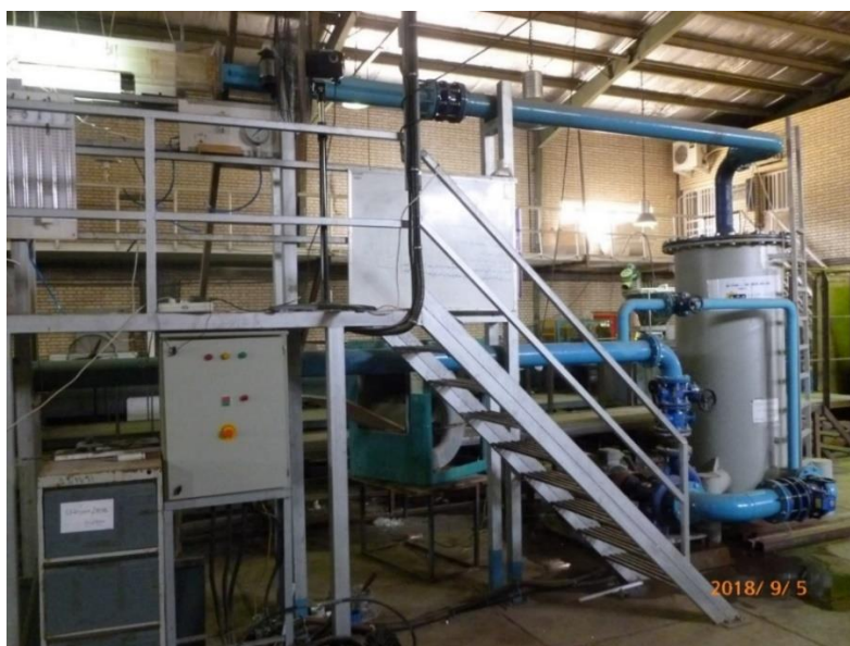
شکل (۱) تصویر تجهیزات تونل آب مدار بسته
