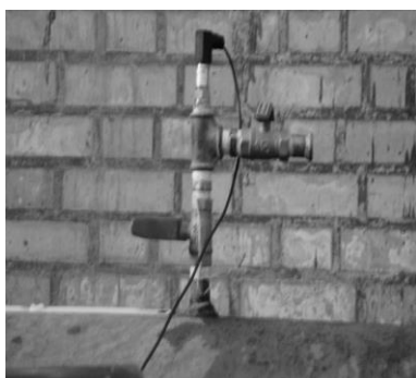
شکل (۴): نصب سنسور فشار
