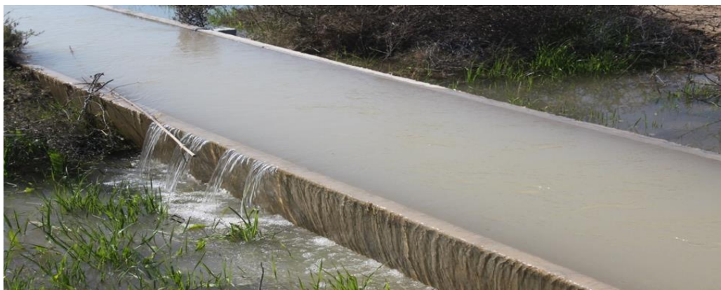
شکل (۴): سرریز آب در بخشی از مسیر کانال‌های دارای مشکل رسوبگذاری در ساحل چپ شبکه آبیاری و زهکشی شهرستان رامشیر
